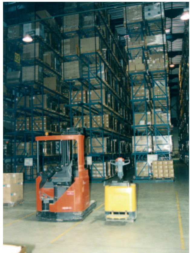
Stockage de grande hauteur. Il faut caractériser l'action des charges isolées statiques générées par les pieds de rayonnage ou le matériel de production
